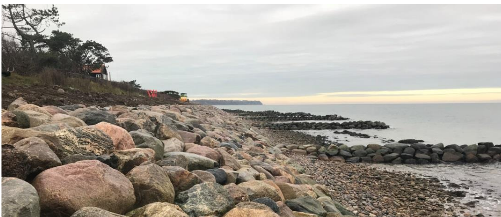
Figur 3.28 Beskyttet kyst med skråningsbeskyttelser og høfder ved Villingebæk (St. 42,2-43,2). Fotoet er taget d. 08-11-2017.
