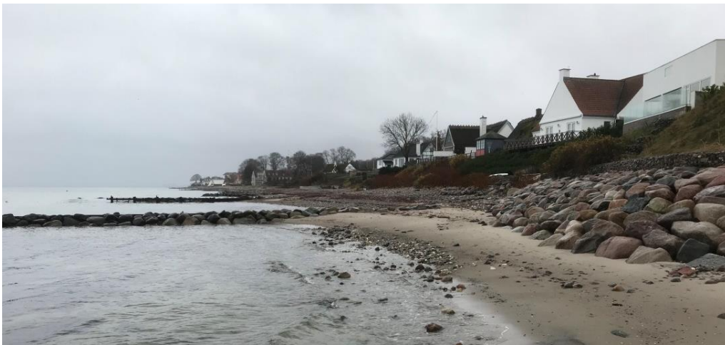
Figur 3.32 Kystbeskyttelse i form af høfder og skråningsbeskyttelser ved Ålgårde (St. 50,5-53,2). Fotoet er taget d. 14-11-2017.
